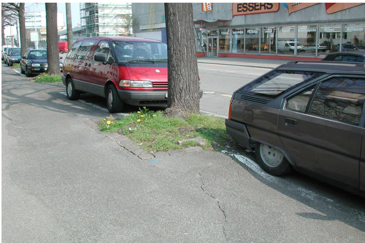
Abbildung 1: aktuelle Situation vom baulichen Zustand
